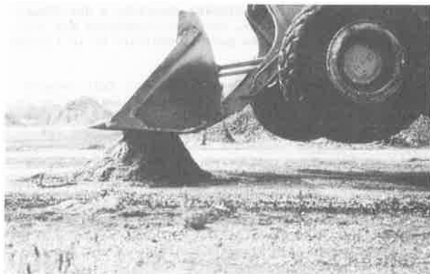
Figure 3 - Charge exercée sur un tas traité à faible dosage. La pente reste stable.
