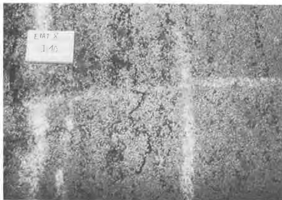
Figure 2 - Enduit superficiel bicouche sur une couche de 30 cm de grave argileuse peu plastique (IP = 8) placée sur un sol support déformable. Fissures formées après huit passages d'un camion chargé à 13 tonnes par essieu.
